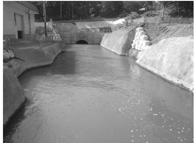
写真－9 かんがい期間 通水状況
