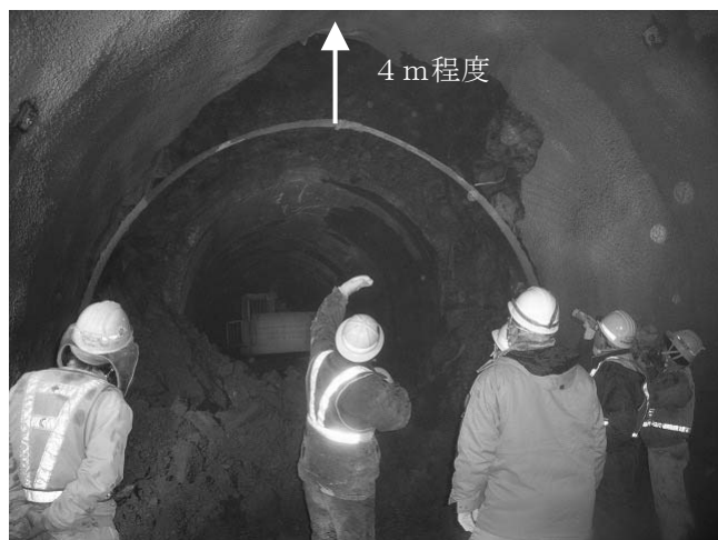
写真－6 大規模な空洞
