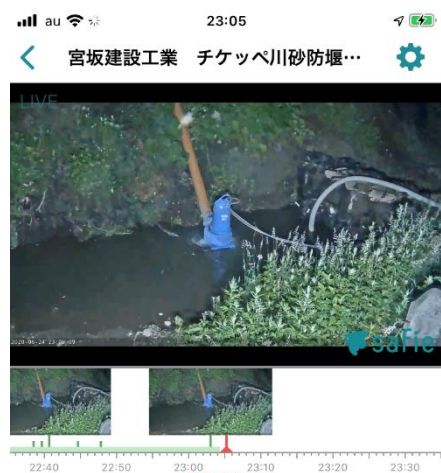
写真-6 スマホによる夜間遠隔監視
