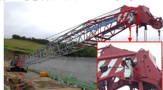
写真-7 クレーンカメラ
