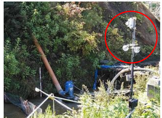
写真-5 河川モニタリング用WEBカメラ
