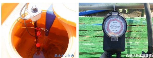
写真-14 自動散水使用機器
