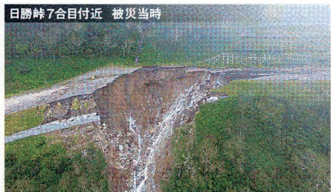
日勝峠7合目付近 被災当時
