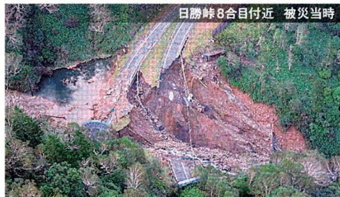
日勝峠8合目付近 被災当時
