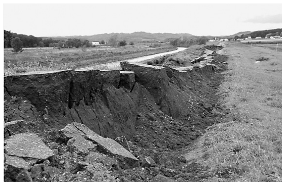
▶十勝沖地震による被害状況
