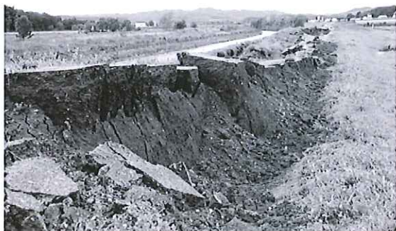
十勝沖地震による被害状況
