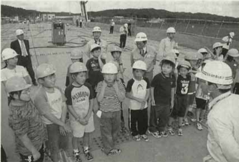
標茶市街地を流れる釧路川に架かる開運橋は、1889年(明治22年)に、木製の橋が架けられたのが始まり。その後、鋼製の橋が架けられたのは、58年の旧橋の老朽化に伴うもの。事業は2002年度から始まり、仮橋の建設や旧開運橋の撤去、04年度からは橋台や橋脚の建設が始まり、今年12月に車道と片側の歩道が開通する見込み。今年度末までには、橋は完成するが、道路を含めたすべての工事が完了するのは07年度の予定。
