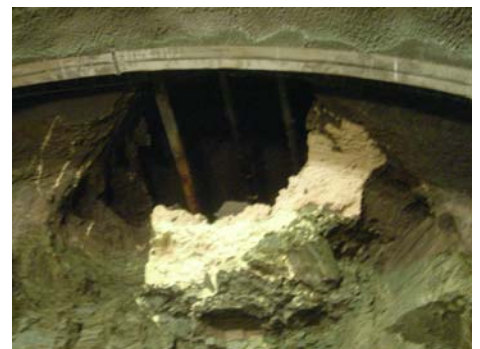
写真 4-3 天端部空洞状態
